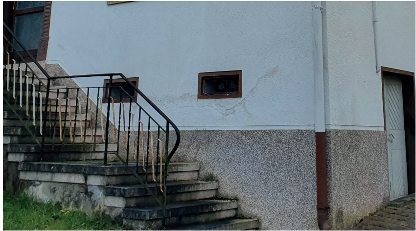
Modernisierungs- und instandsetzungsbedürftiges Gebäude mit mittlerem Bedarf
