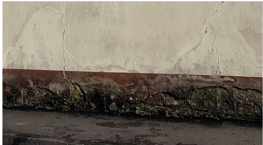
Modernisierungs- und instandsetzungsbedürftiges Gebäude mit hohem Bedarf
