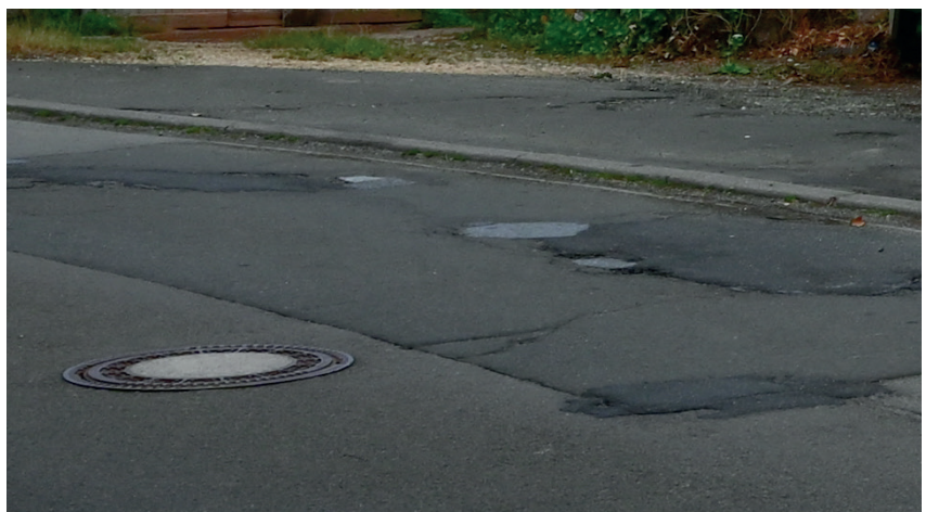
Missstand: sanierungsbedürftige Fahrbahndecken im Bereich der Hauptstraße
