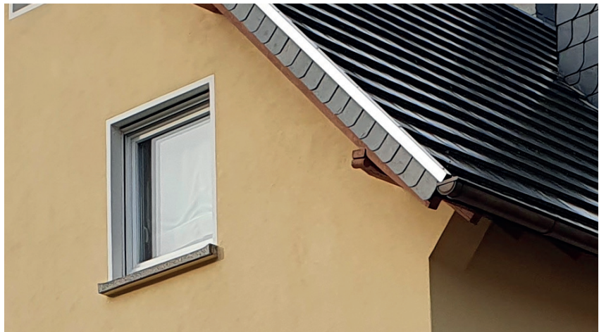
Modernisierungs- und instandsetzungsbedürftiges Gebäude mit geringem Bedarf
