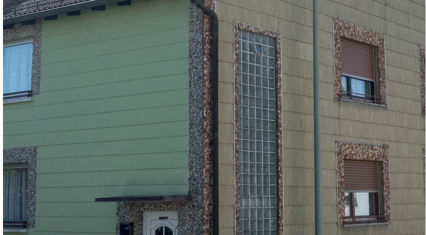
Missstand Beispiel: Materialität der Fassade (Faserzement)
