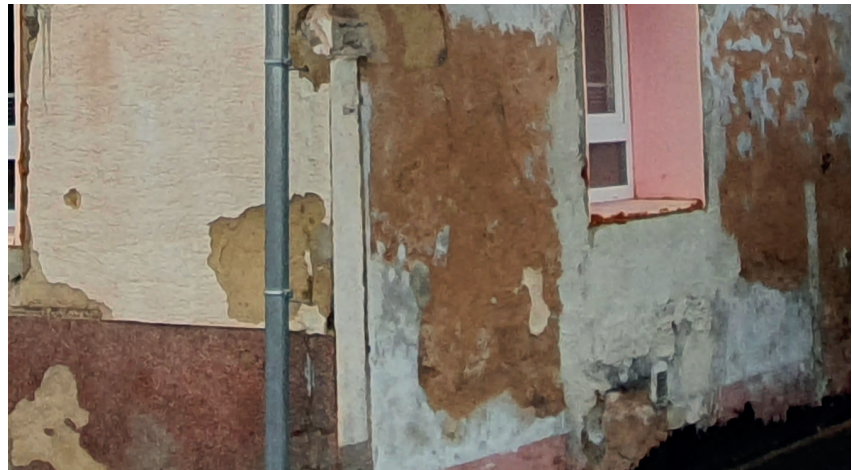
Modernisierungs- und instandsetzungsbedürftiges Gebäude mit hohem Bedarf
