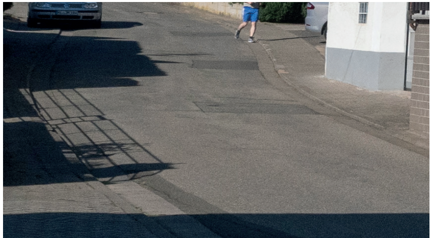
Misstand: sanierungsbedürftige Fahrbahndecken im Bereich der Johannesstraße
