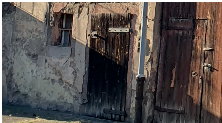
Modernisierungs- und instandsetzungsbedürftiges Gebäude mit hohem Bedarf
