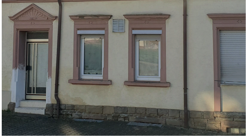
Modernisierungs- und instandsetzungsbedürftiges Gebäude mit mittlerem Bedarf
