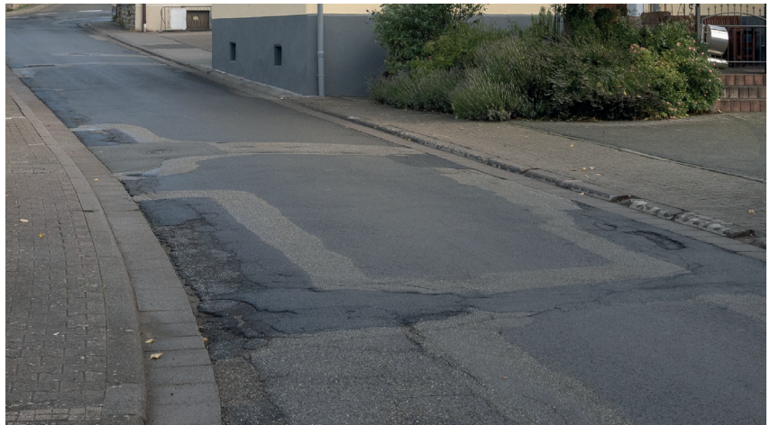
Misstand: Sanierungsbedürftige Fahrbahndecke im Bereich der Lindenstraße
