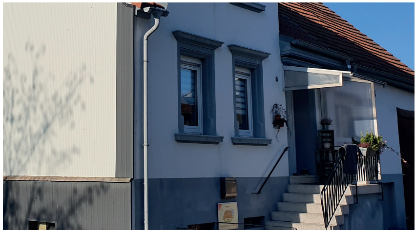
Modernisierungs- und instandsetzungsbedürftiges Gebäude mit geringem Bedarf
