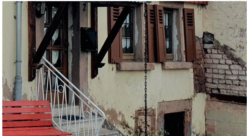
Modernisierungs- und instandsetzungsbedürftiges Gebäude mit hohem Bedarf
