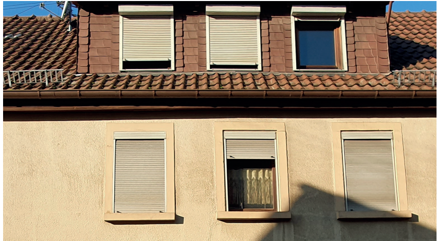
Modernisierungs- und Instandsetzungsbedürftiges Gebäude mit mittlerem Bedarf
