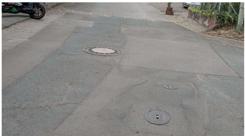
Misstand: sanierungsbedürftige Fahrbahndecke im Bereich der Hebelstraße
