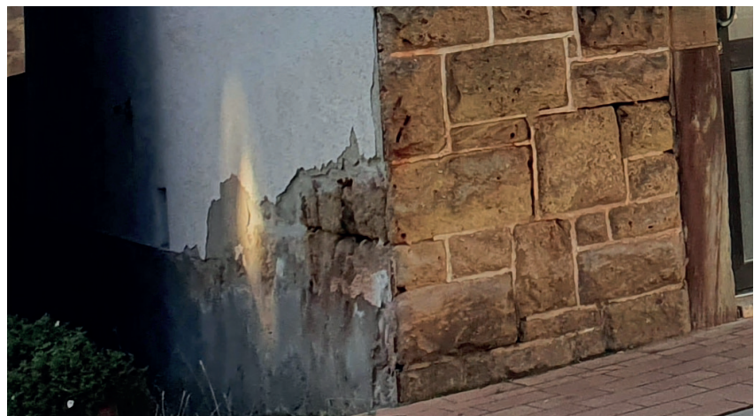
Modernisierungs- und instandsetzungsbedürftiges Gebäude mit hohem Bedarf
