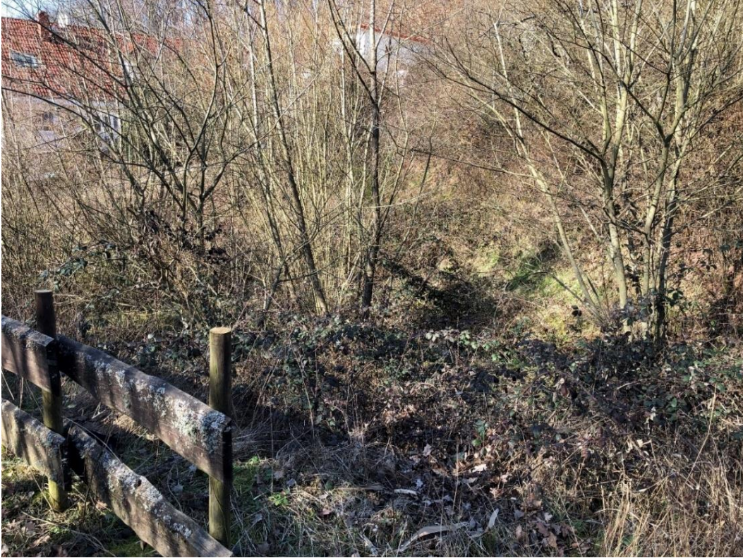
Abb. 87: Zugewachsenes Regenrückhaltebecken an der Bergstraße
