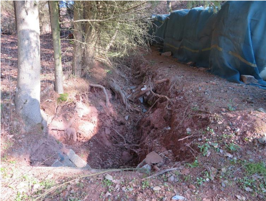
Abb. 73: Erosionsschäden an dem Gewässer hinter Silageballen
