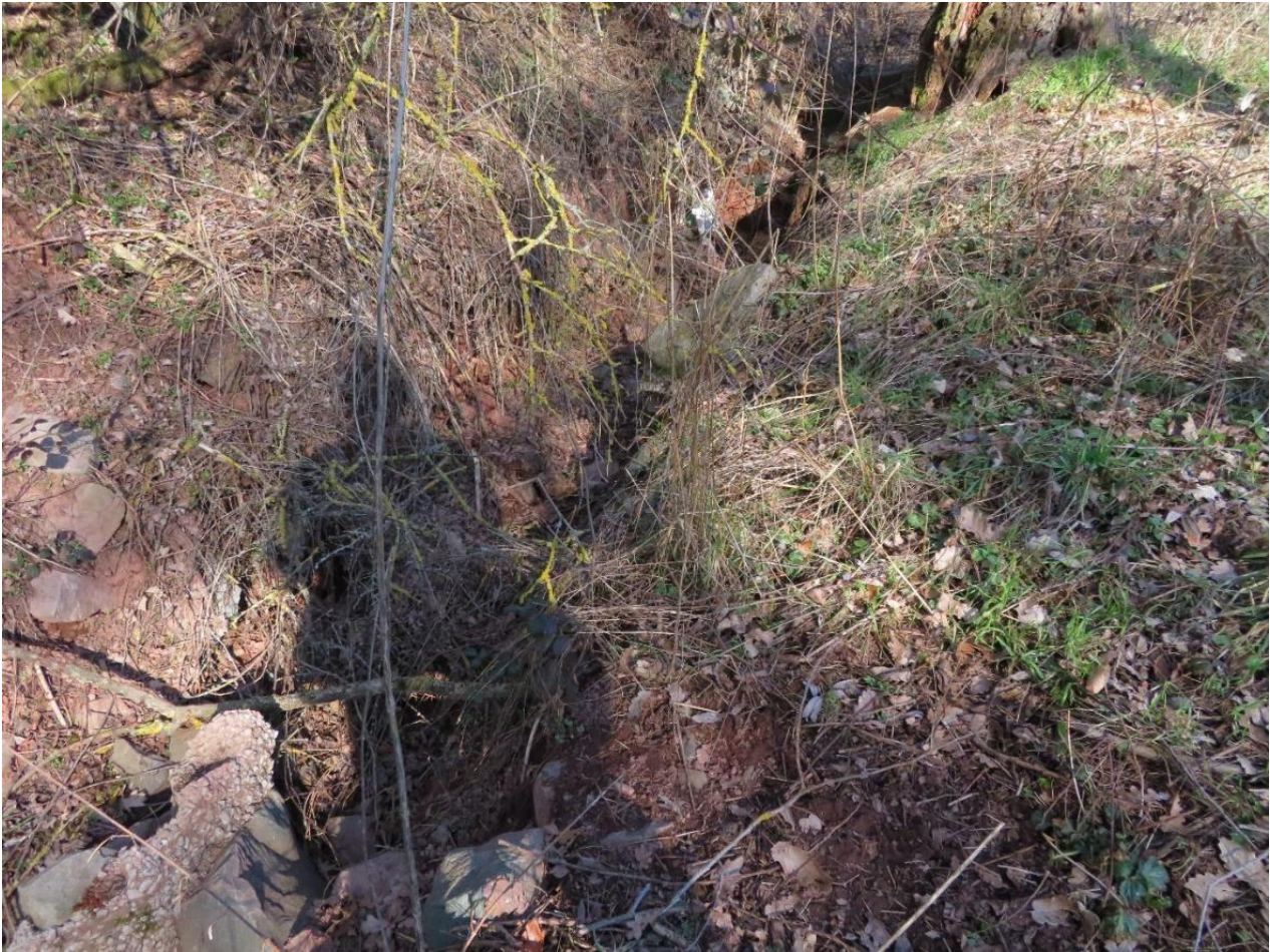
Abb. 69: Stark erodierter Bachlauf (Am Köttenberg)
