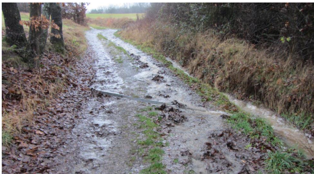
Abb. 108: Wilder Oberflächenabfluss auf unbefestigtem Weg bei Starkregen, Foto: OG
