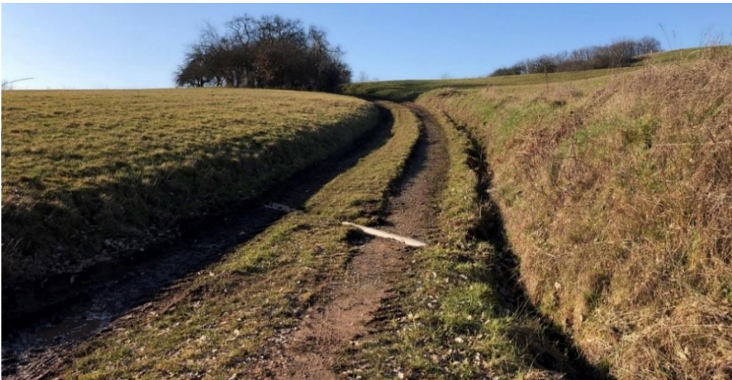
Abb. 111: Unzureichend entwässerter Wirtschaftsweg in Verlängerung der Straße „Zum Kreimberg“
