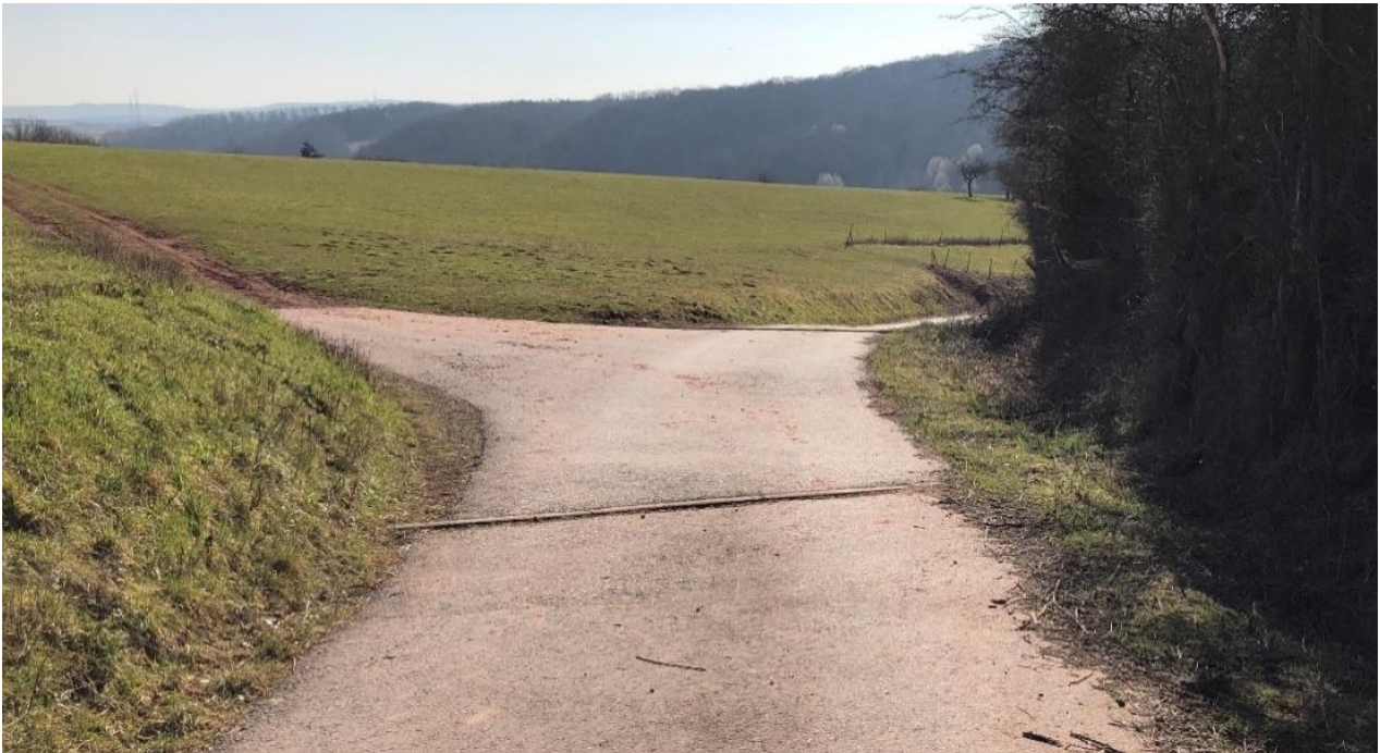
Abb. 68: Querrinne im Wirtschaftsweg mit fehlender Vorflut
