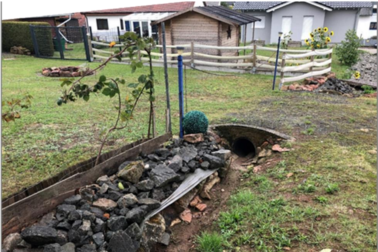
Abb. 113: Seitengraben zur Entwässerung von Außengebietswasser am Bebauungsrand
