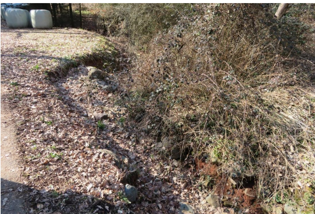
Abb. 72: Erosionsschäden am Gewässerlauf Am Köttenberg
