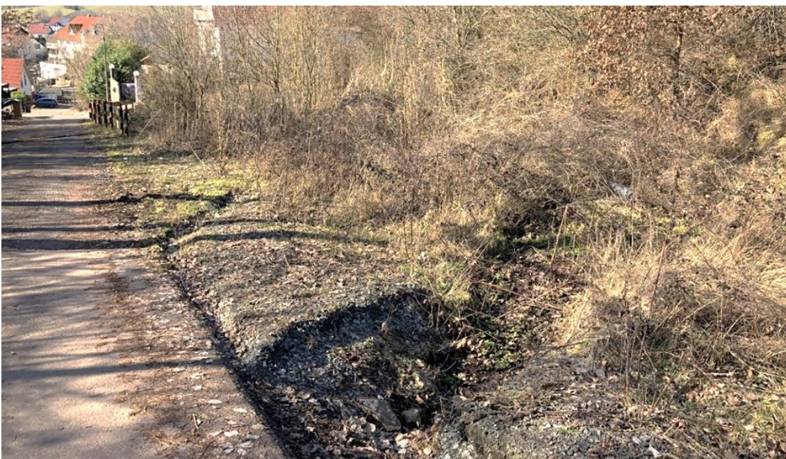
Abb. 85: Erosionsschäden im Bankett des Wirtschaftswegs zur Bergstraße
