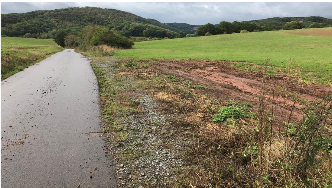
Abb. 65: Streckenweise verfüllter Wegseitengraben
