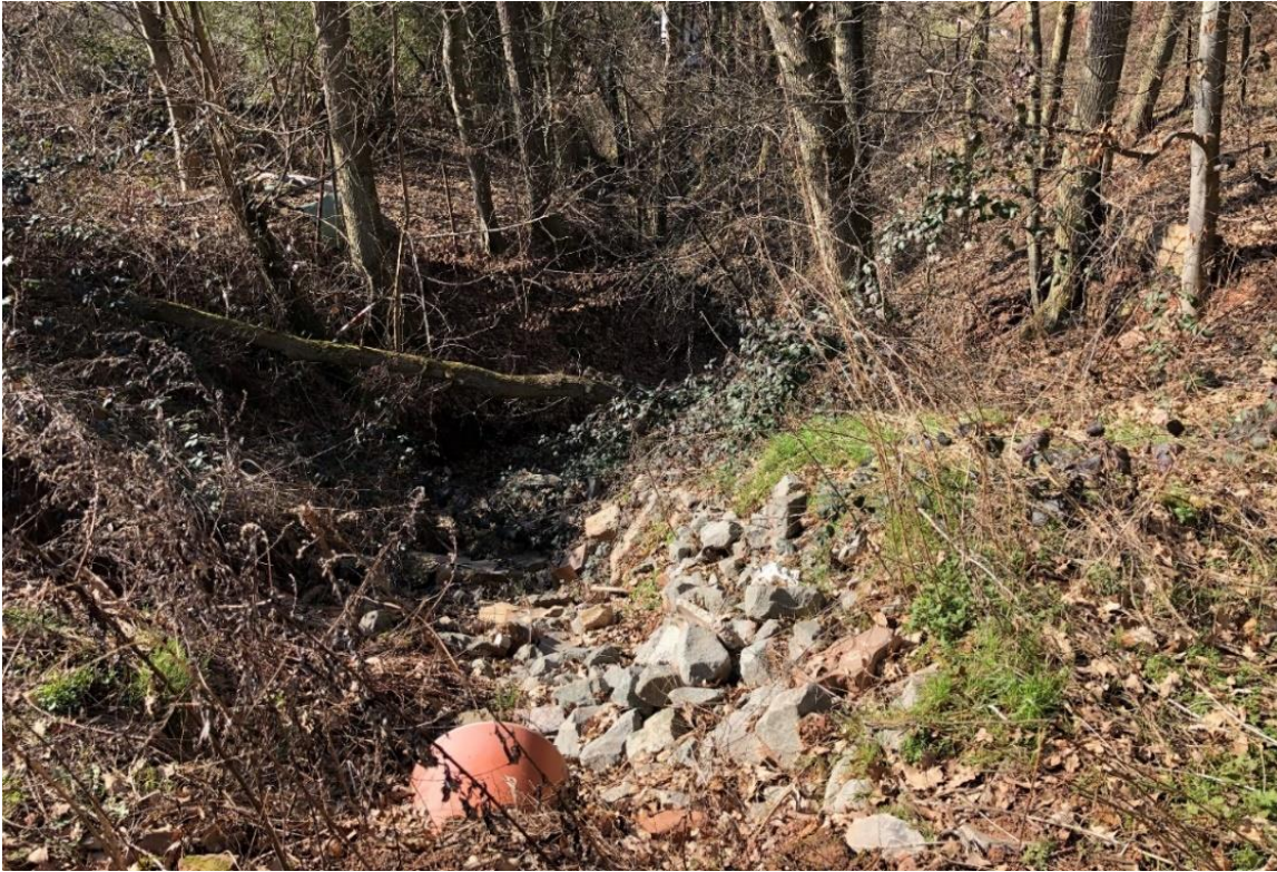
Abb. 75: Ausmündung der Verrohrung in naturnahes Waldgelände Am Köttenberg
