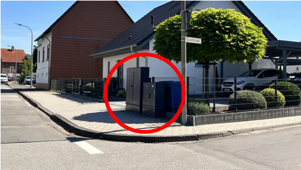
Abb. 36: Neue Stromverteilerkästen in der bekanntermaßen überflutungsgefährdeten Lauterstraße
