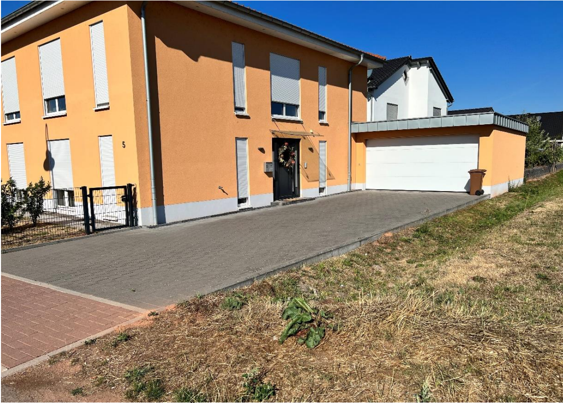
Abb. 62: Beispiel für starke Überflutungsgefährdung durch tiefliegende Türen und Tore
