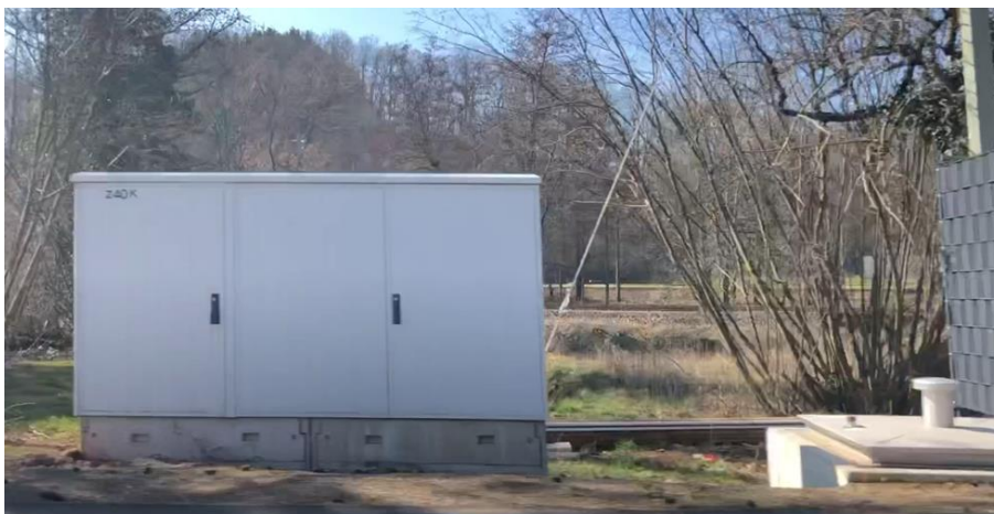
Abb. 46: Potenziell überflutungsgefährdete Abwasserpumpstation mit Stromverteilerkasten
